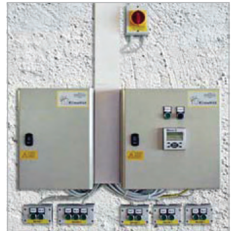
Je nach Bedarf kann vor Ort die Klimasteuerung von Automatik- auf Handbetrieb umgestellt werden.
